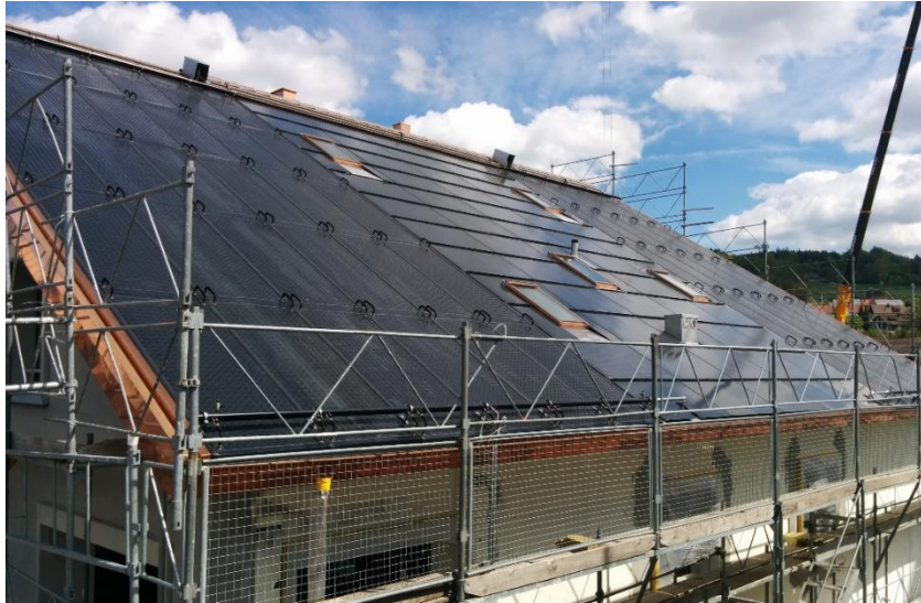
Abbildung 2.2: Solardach von Energie Solaire SA
