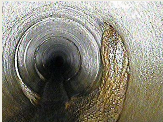
Foto 37: Anschluss bei 2 Uhr mit Inkrustation und fließendem Wasser
