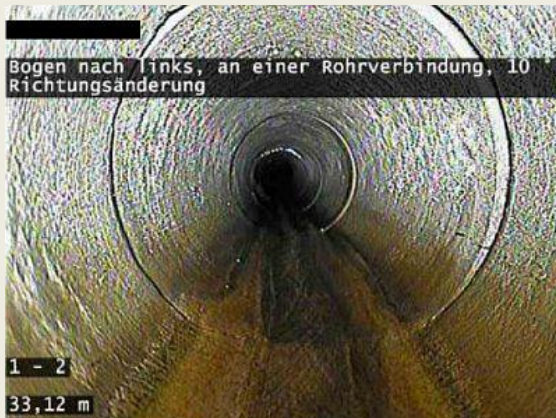
Foto 11: Knick an Rohrverbindung
