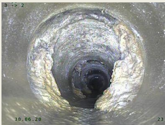
Foto 22: Inkrustation an Rohrstößen
