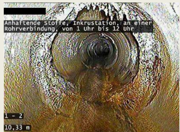
Foto 23: Inkrustation an Rohrstößen
