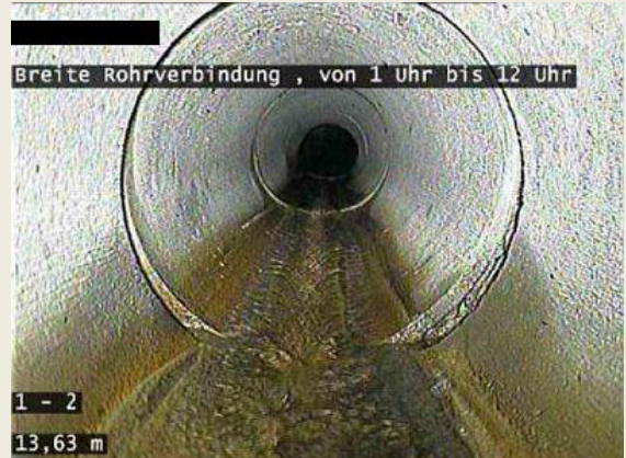
Foto 8: Breite Rohrverbindung, Schüttmaterial sichtbar bei 5 Uhr
