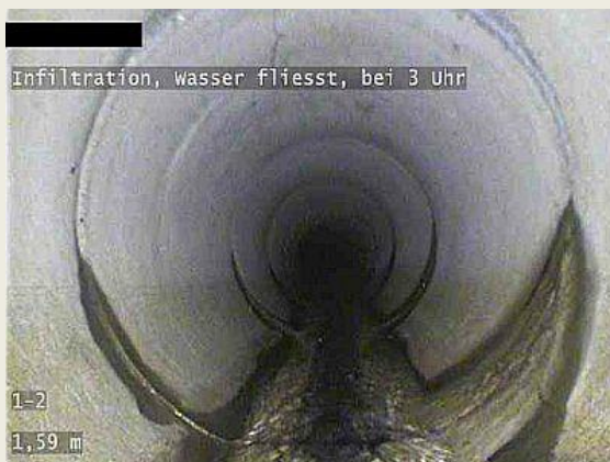
Foto 17: Wasser fließt an einer Rohrverbindung bei 3 Uhr
