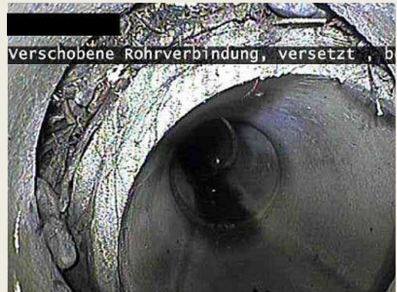
Foto 10: Versetzte Rohrverbindung, Schüttmaterial sichtbar
