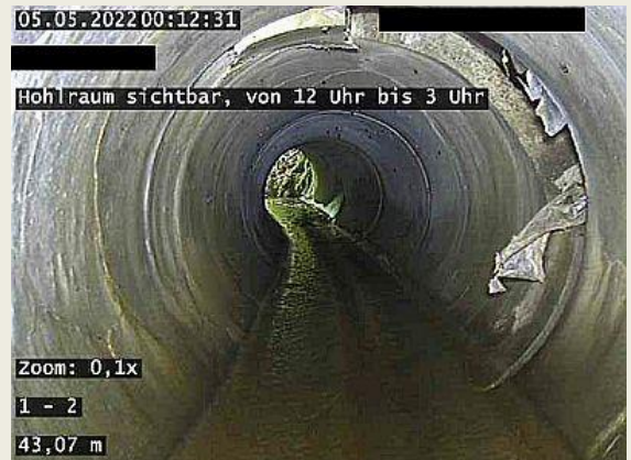
Foto 34: fehlende Scherbe / Wandungsteil
