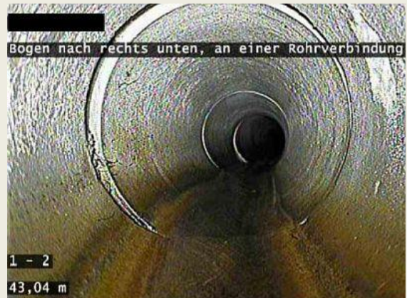
Foto 12: Knick an Rohrverbindung, Schüttmaterial sichtbar
