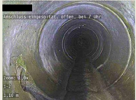
Foto 36: Anschluss mit fließendem Wasser bei 7 Uhr
