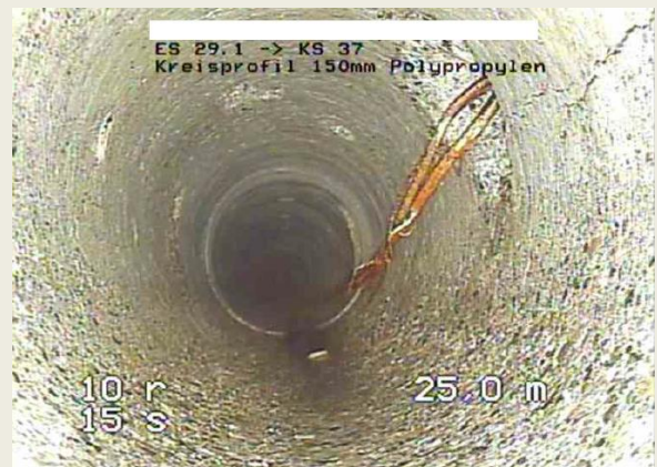
Foto 26: Risse, Pfahlwurzel bei 2 Uhr
