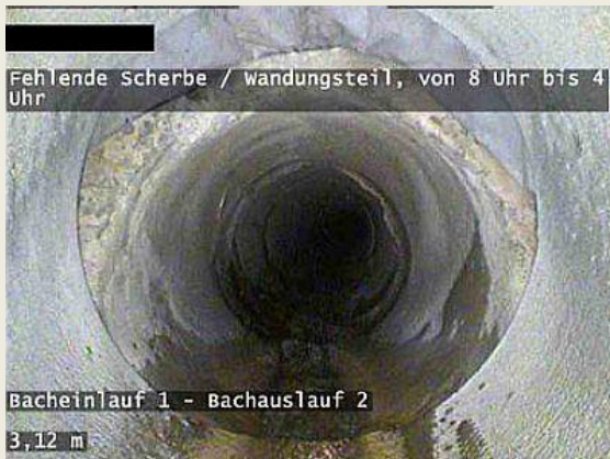
Foto 33: fehlende Scherbe / Wandungsteil
