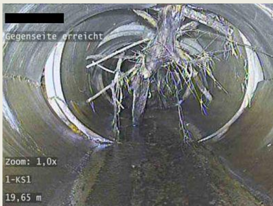
Foto 25: Risse, Pfahlwurzel bei 12 Uhr
