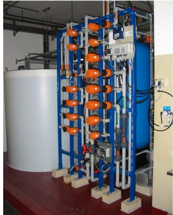
Abbildung 19: Anlage zur Chromsäure-Reinigung ohne Spülwasser-Verdunster
