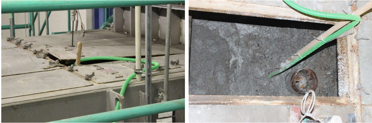
Abb. 61a und b: Entschlackwasserentnahme Verbrennungslinie 1, KVA Winterthur. Saugschlauch oben aus dem Entschlacker nach unten geführt zum Abziehen der Flüssigkeit mittels Heberwirkung (links), Blick in den Entschlacker auf die Schwimmdecke.
