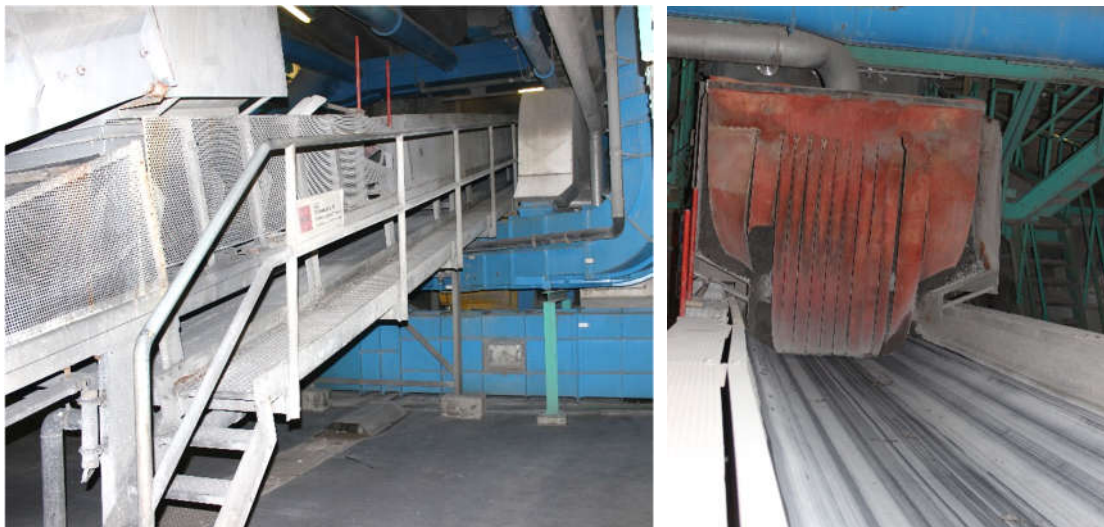
Abb. 115: KVA Winterthur: Austragsband einer Verbrennungslinie zum Schlackenbunker (links); Blick vom Begleitsteg auf das Band (rechts).
