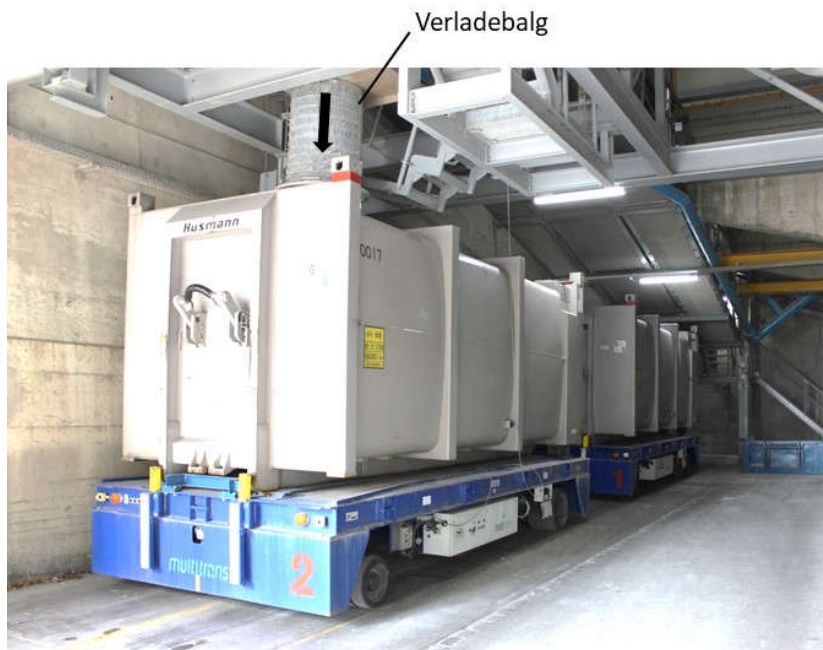
Abb. 110: Schlacke-Verladestation an der KVA Horgen. Container stehen auf Rangierwagen; Anschluss mittels Verladebalg.
