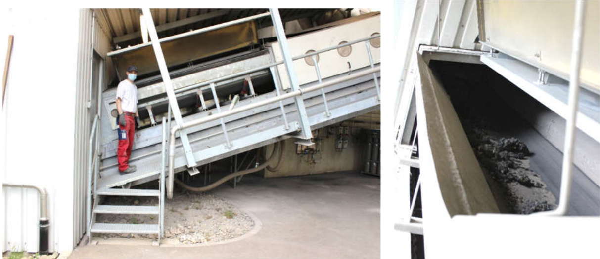
Abb. 114: Mögliche Probenahmestelle KVA Hinwil am Steigband Richtung Aufbereitung der ZAV Recycling AG. In den Bildern ist einer der jeweils ca. 3 m langen Deckel geöffnet.
