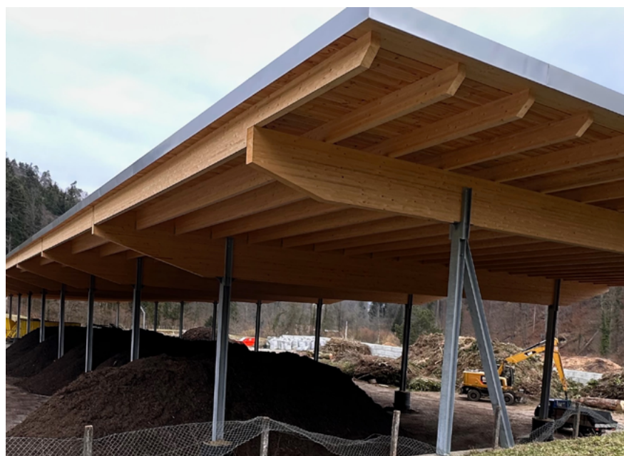
Foto 6: Neue Kompostierhalle in Winterthur Töss: Die Verarbeitung unter Dach hat den Vorteil von weniger Abwasser und gleichzeitig kann die Wasserzufuhr kontrolliert erfolgen, um den Ansprüchen des Gartenbaus zu genügen. Der Gartenbau bezahlt nicht nur den Düngerwert; je nach Qualität der Produkte kann mit der Bezahlung von Fr. 20.– bis 60.– pro Kubikmeter gerechnet werden. Aber dafür muss die Qualität garantiert werden können.
