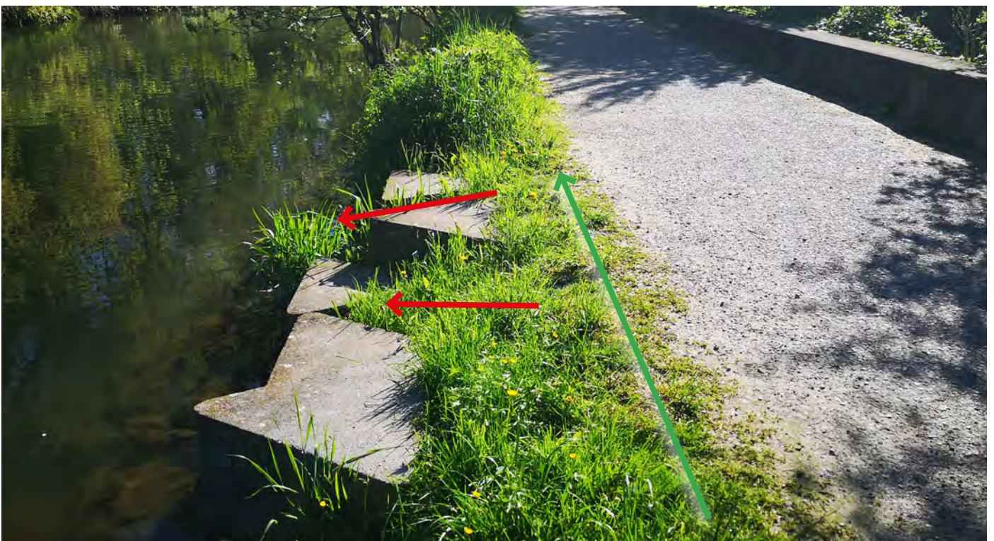
Die Vegetation zwischen den Dreieckselementen am Aabach im Stadtpark Uster lässt sich nur von Hand pflegen (rote Pfeile). Maschinen können nur im oberen Bereich dem Weg entlang eingesetzt werden (grüner Pfeil). © AWEL
