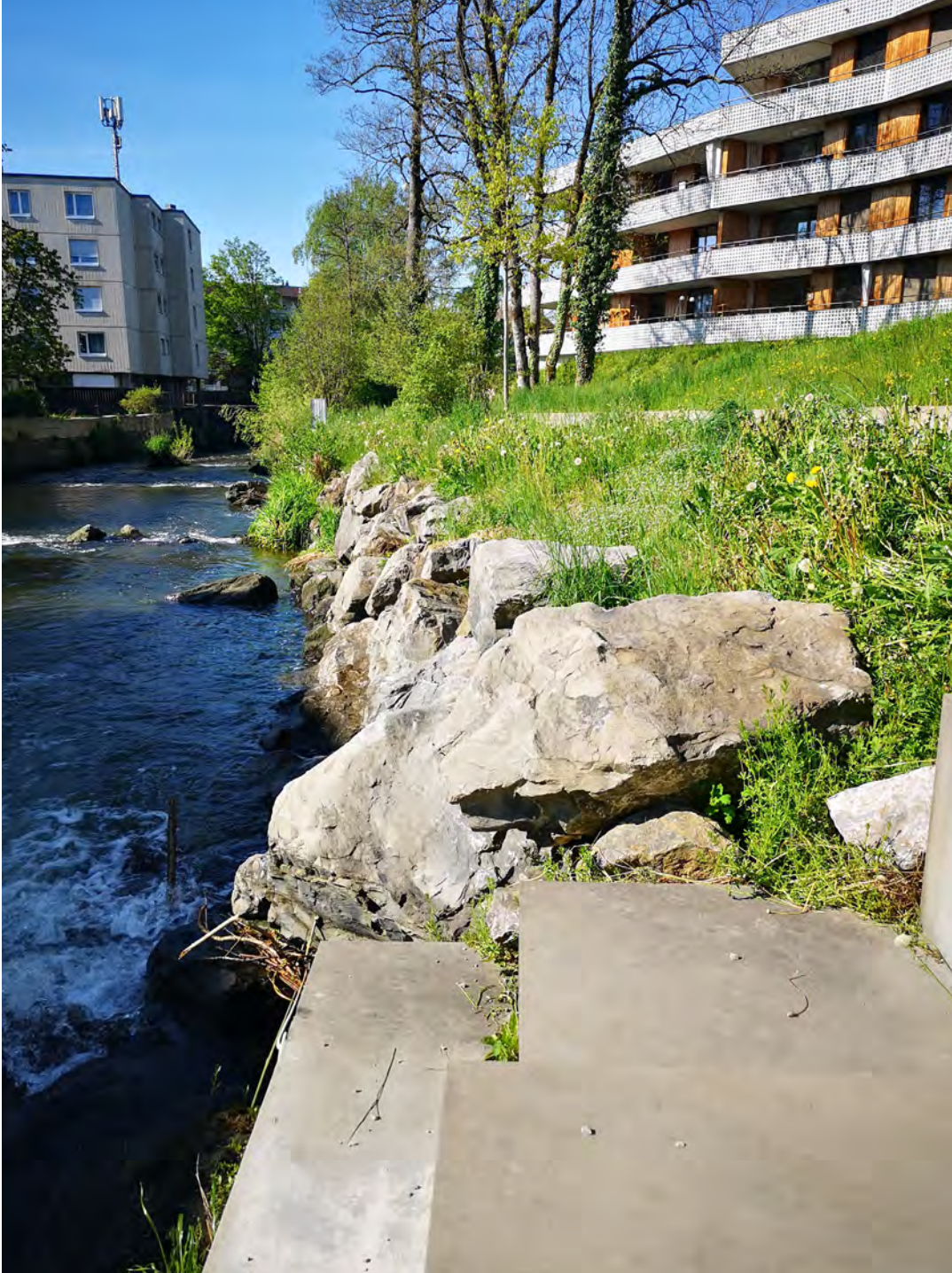
Abrupter Übergang von flacheren Sitzstufen auf steile Böschung aus Steinblöcken am Aabach in Uster. © AWEL
