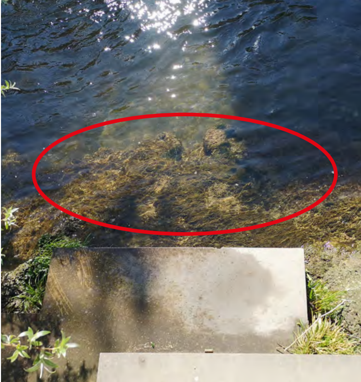
Unvollständig zurückgebaute ehemalige Uferverbauung aus Beton am Aabach im Zellwegerareal in Uster, die zunehmend unterspült wird. © AWEL
