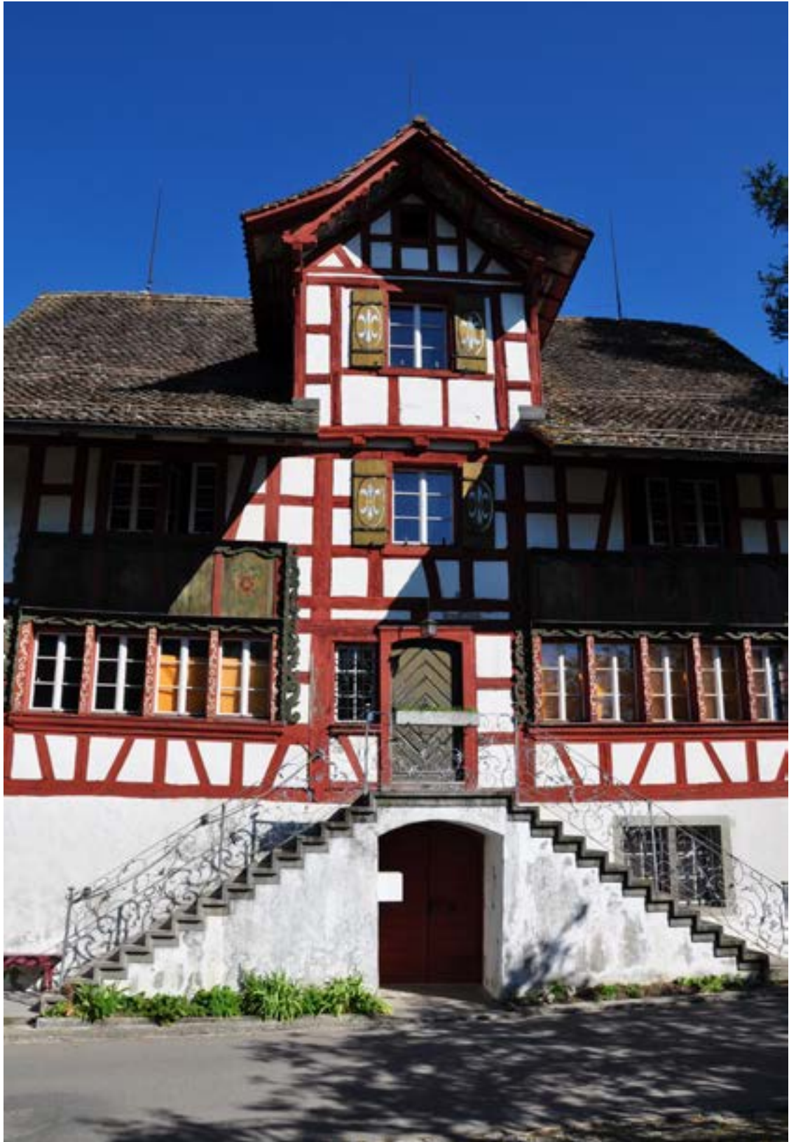
Südfassade - Falsche Materialien bei der letzten Sanierung (1972–75) führten zu Schäden an Putz und Riegelwerk.
