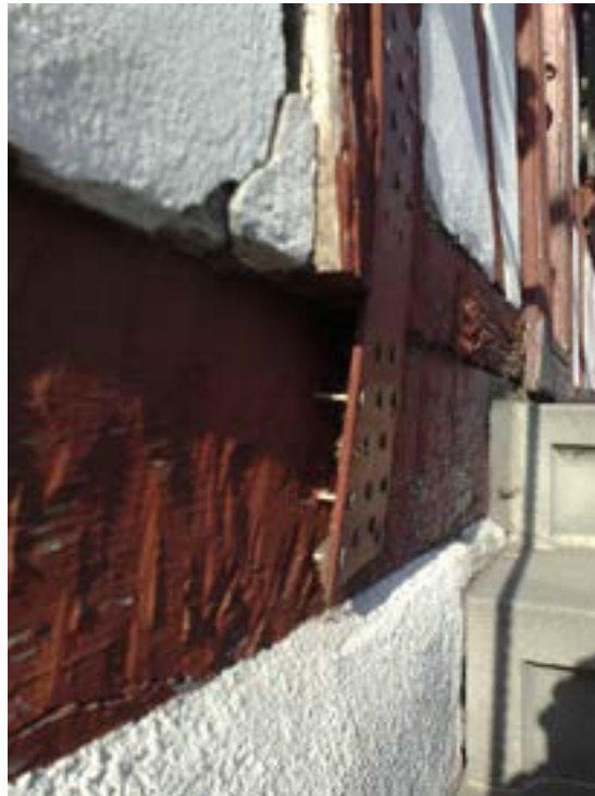
Statischer Mangel führt zu Abkippen der Fassade
