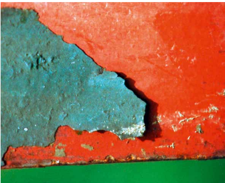
Abwitternde Deckbeschichtung über Grundbeschichtung.
