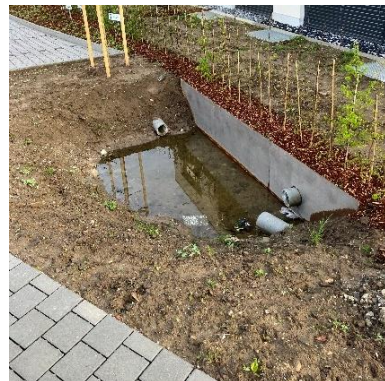
sollte saniert werden
