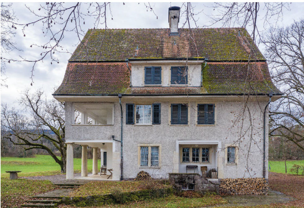
Landsitz Fluh, Landhaus (Vers. Nr. 00372), Nordostfassade mit Lauben und Eingang zur Küche (rechts), 03.12.2020 (Bild Nr. D101971_70).
