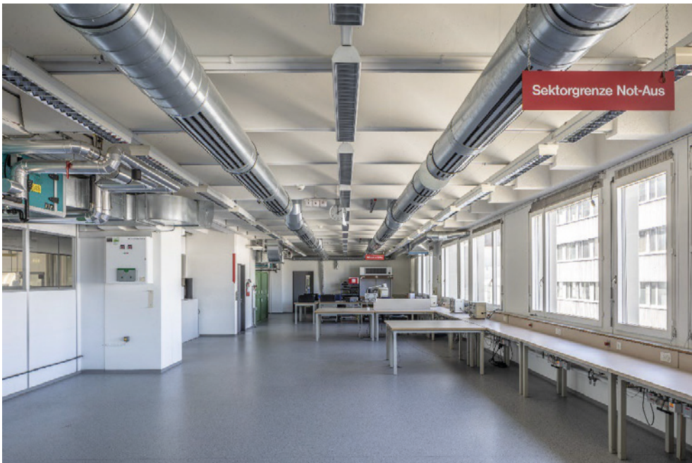
Ehem. Zentrallager, nordöstlicher Bürotrakt, nach NW ausgerichteter Raum, Blick Richtung SW, 18.04.2019 (Bild Nr. D104015_85).
