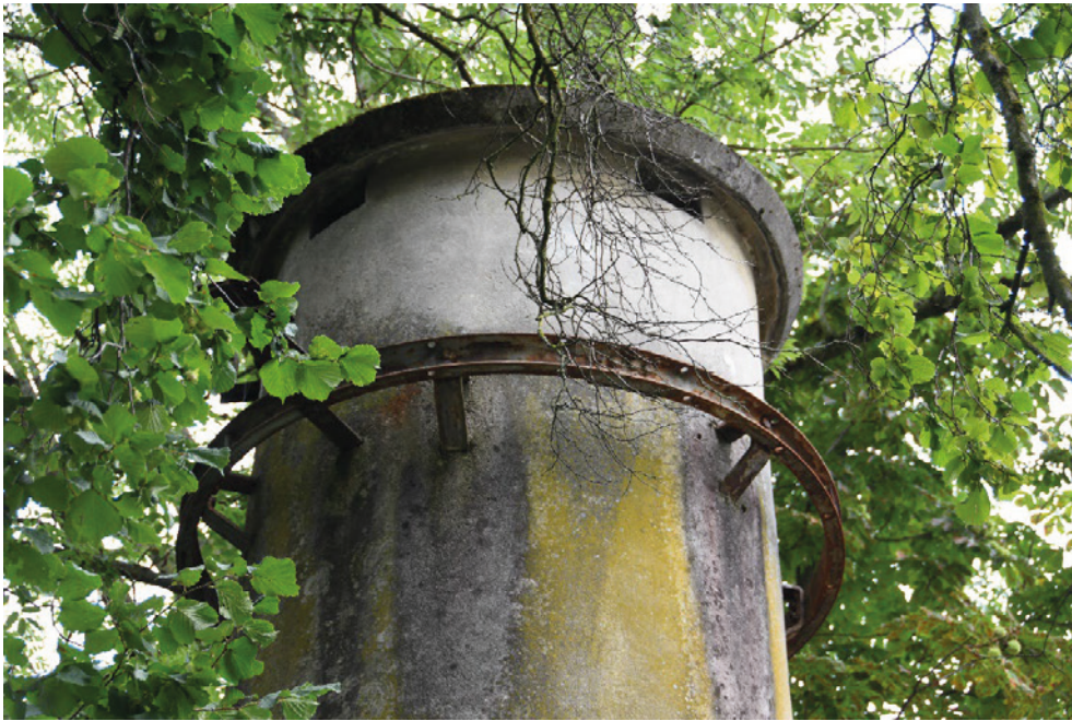
Transformatorstation «Wangen-Färberei», Rundturm mit Metallring zur Befestigung der Isolatoren, 23.08.2019 (Bild Nr. D100587_94).
