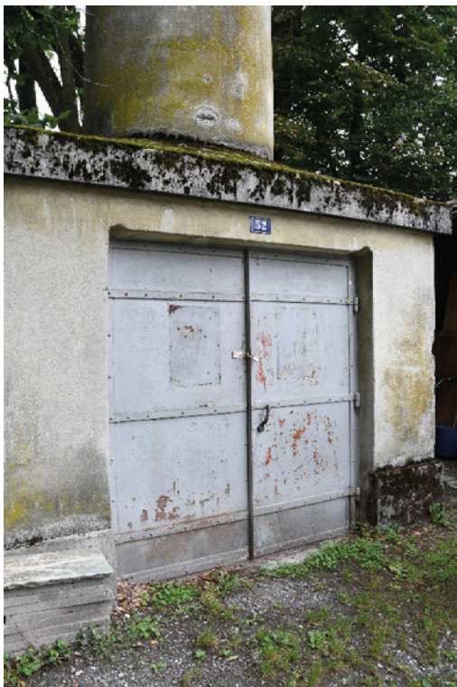
Transformatorstation «Wangen-Färberei», Unterbau mit Metalltor, welches die Bedienungseinrichtung schützt, Ansicht von S, 23.08.2019 (Bild Nr. D100587_96).
