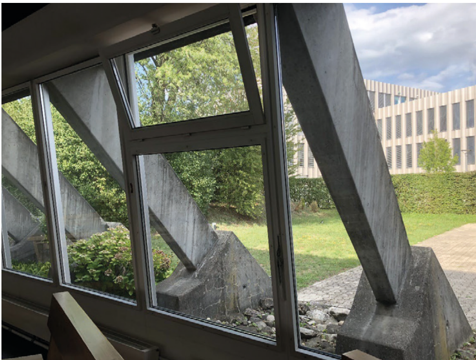
Kath. Kirche Bruder Klaus, Blick vom Kircheninnenraum auf die Betonbinder mit Widerlagern im NO, 29.08.2018 (Bild Nr. D101399_17).
