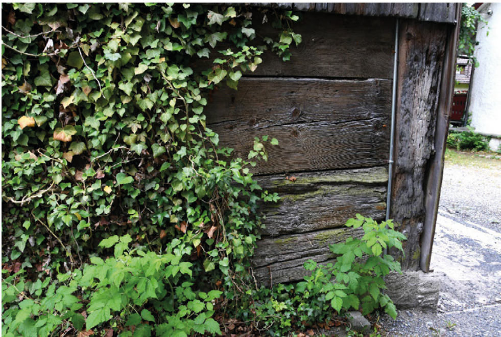
Vielzweckbauernhaus, Hausteil West (Vers. Nr. 00083), Nordwestecke, in den Eckständer eingenuetete Bohlen, 09.06.2017 (Bild Nr. D100691_78).
