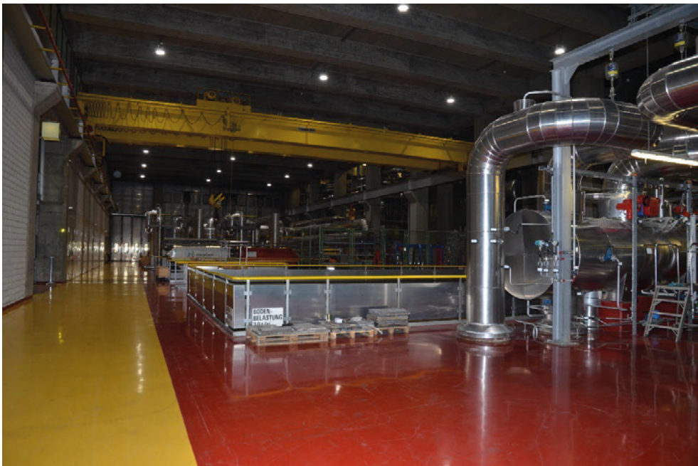
Heizkraftwerk Aubrugg, Inneres der Maschinenhalle (069HALLE01953), 16.10.2017 (Bild Nr. D100691_76).
