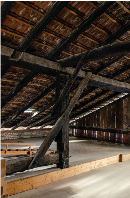
Ehem. Vielzweckbauernhaus, rauchgeschwärzte Dachkonstruktion mit Innenständer, Sperrafe und Strebe, 19.10.2022 (Bild Nr. D100694_07).
