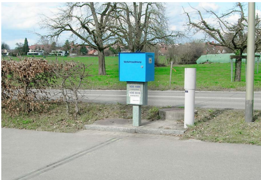
Die MIV- und Velozählstelle in Greifensee erfasst alle Velofahrenden auf dem Radweg. Die Technik für die Zählung der Velos wurde in die bestehenden MIV-Zählkästen integriert.
