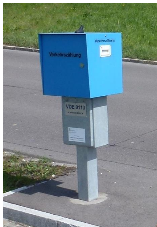
Abbildung 7: Messmasten mit montiertem Apparateschrank
