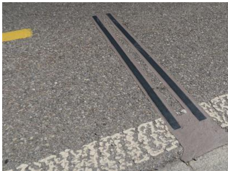
Abbildung 23: Im Strassenbelag eingebaute Sensoren (Radstreifen)
