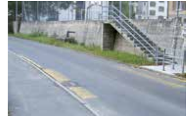
Fussgängerstreifen ist nicht mehr erkennbar.
