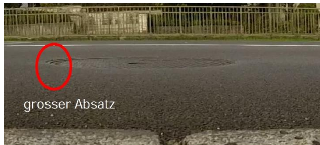
Abbildung 1: Schachtdeckel vor den Nachbesserungsarbeiten
