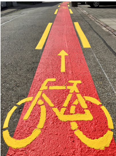
Eine wichtige Rolle im Strassenbau werden künftig die neuen Velostandards für eine sichere und attraktive Veloinfrastruktur im Kanton Zürich spielen. Foto: Viktoria Herzog
