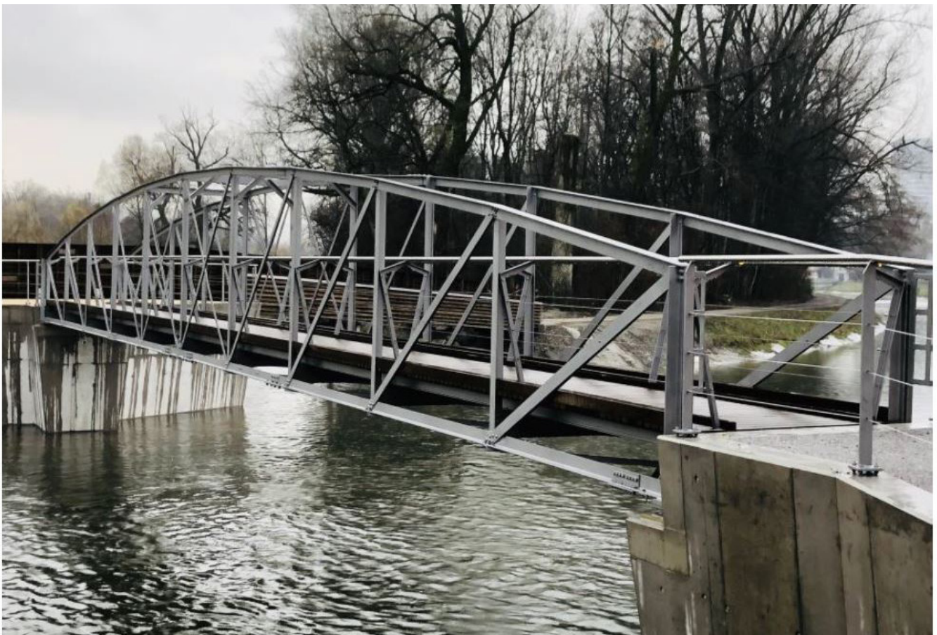
Mit der Sanierung der Reppischbrücke in Dietikon konnte das filigrane Bauwerk aus dem Jahr 1895 erhalten werden.
