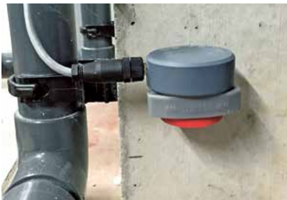
Abb. 7.2.8 Ozonüberwachung im Technikraum
