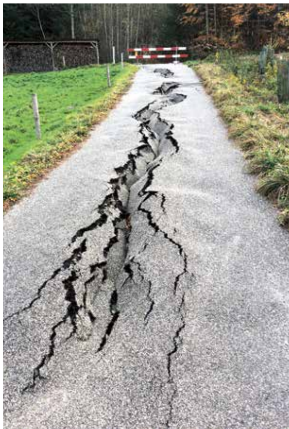
Abb. 7.1.1 Unterspülte Strasse nach Rohrbruch
