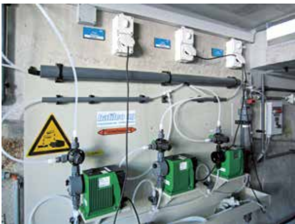
Abb. 8.1.2: Dosierstation für Schwefelsäure in einem Schwimmbad
