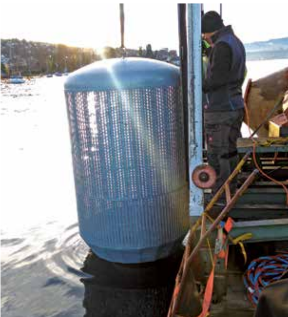
Abb. 7.1.6: Absenken des neuen Fassungskorbes auf 35 m Tiefe zur Montage durch die Taucher.
