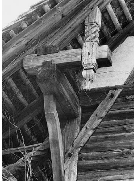
Doppelbauernwohnhaus Ober Ödischwänd Vers.-Nr. 1401. Links: Abort-Erker in der nördlichen Giebelwand. Rechts: Flugsparrendreieck in der Nordostecke.
