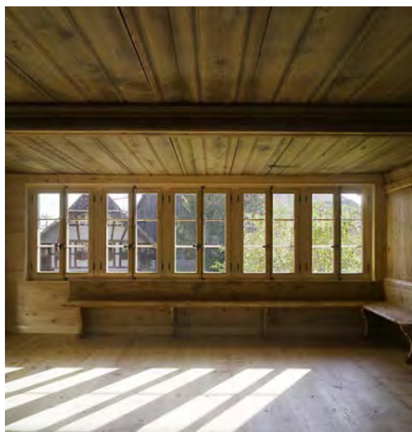
Bauernstube nach Innendämmung. feinfühlig differenzierte neue Deckschicht im Gurtendörfli, Gemeinde Köniz. Der Raum behält seine stoffliche und räumliche Einheitlichkeit. Urech Architekten AG, Köniz. (Abb. 76)
