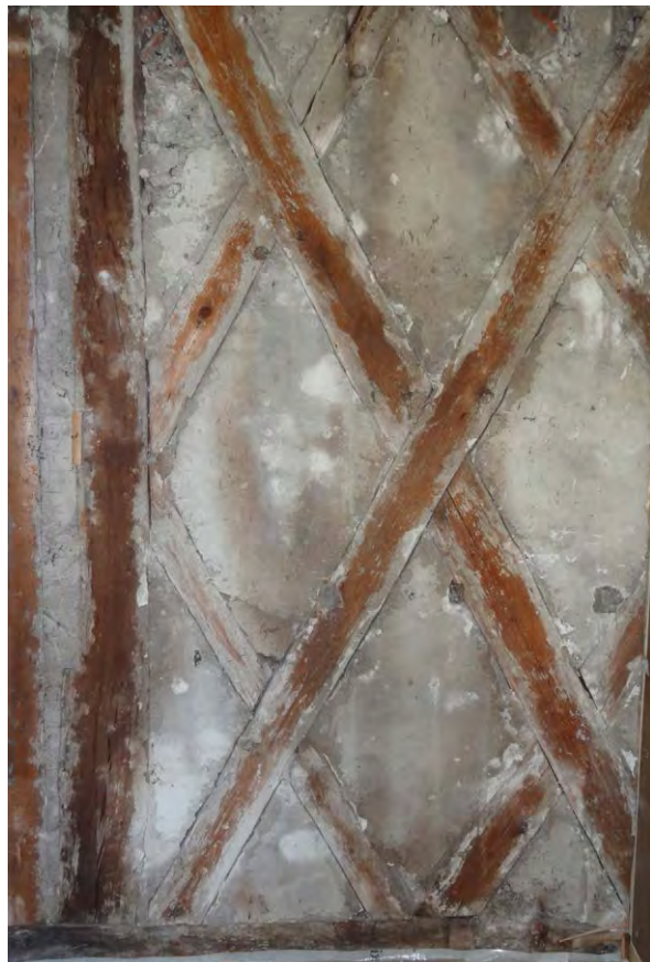
Aussenwand von 1690, Ansicht der raumseitig verputzten Gefache nach der Demontage der Täfer (Abb. 72)
