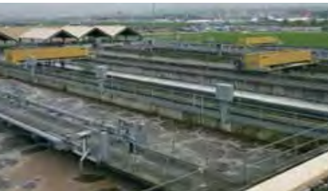
Abwasserreinigungsanlage in Betrieb
