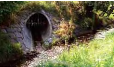
Einleitung aus Mischwasserentlastung
