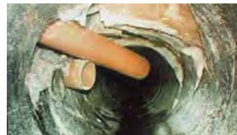
Nicht fachgerecht ausgeführte Kanalisationsanschlüsse
