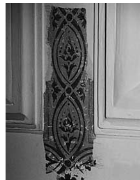
Vorübergehend freigelegte Ornementmalerei, 18. oder 19. Jahrhundert, Gold auf ockerfarbenem Untergrund, an der Decke im Generalszimmer des Terrassengeschosses. Zustand 1993.
