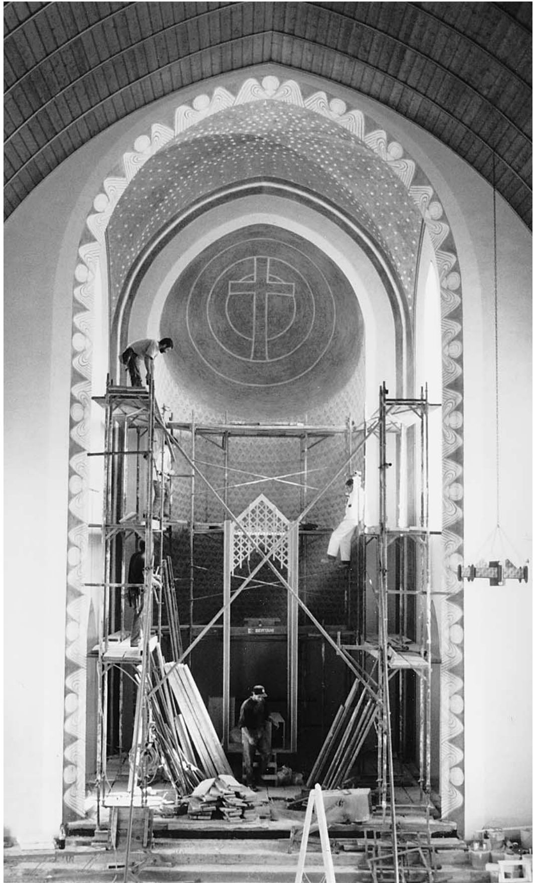
Abbau des Gerüstes nach der Ausmalung, Zustand am 23. Juli 1993. Photo Fontana & Fontana, Jona-Rapperswil/SG.
