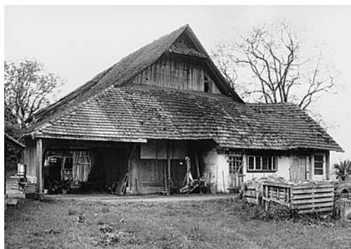
Links: Maschwanden, Ehem. Bauernhaus und Scheune mit Ortsmuseum Vers. Nrn. 105/106/165, Unterdorf, nach der Renovation 1992–1993.
