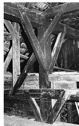
Dachkonstruktion über der Wand zwischen Tenn und Wohnteil. Photo M. Flachsmann, IGA, 1991.
