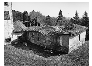
Das 1851 erbaute Badehaus im März 1977, nachdem das Walmdach unter der Schneelast eingestürzt war und bevor das ganze charakteristische Gebäude abgebrochen wurde. Vgl. Bild oben.
