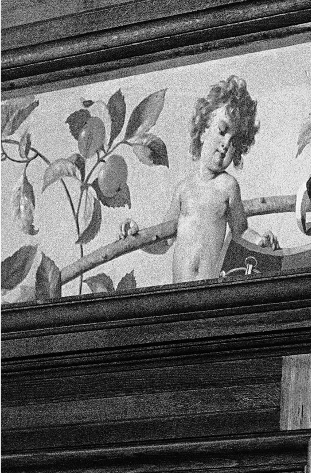
Bäretswil, Neuthal, Wohnhaus Vers. Nr. 509 der ehem. Baumwollspinnerei A. Guyer-Zeller. Wandmalerei um 1890 im Saal des Erdgeschosses. Zustand 1974.
