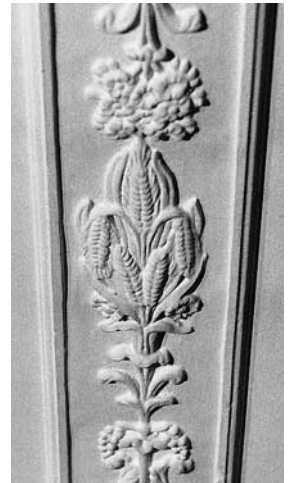
Detail der Stuckierung im Südraum des 1. Obergeschosses im 1843–1844 erbauten Haus Vers. Nr. 414.
