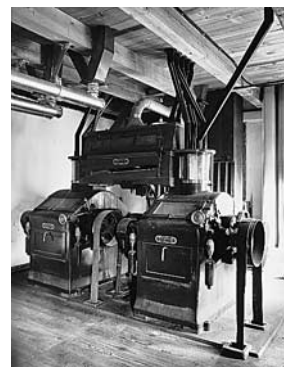
Mühleraum im 1. Obergeschoss mit zwei Walzenstühlen aus den 1930er Jahren von Maier & Cie., Gossau/SG. Die Mahlanlage wurde schon vor dem Umbau entfernt. Zustand 1984.
