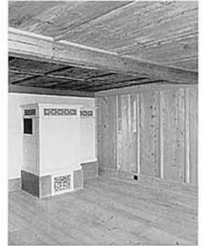
Stube des nordöstlichen Hausteils. Das Decken- und Wandtäfer konnte restauriert werden. Der Ofen um 1840 wurde anstelle eines grösseren aus der Zeit um 1900 aufgesetzt. Zustand 1991.
