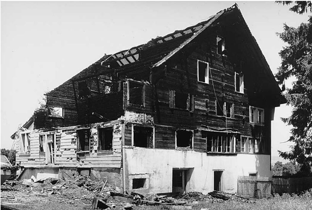
Nach dem Brand vom 26. Juni 1993 konnte das Haus nicht mehr restauriert werden und wurde weitgehend abgebrochen. Zustand Juni 1993.
