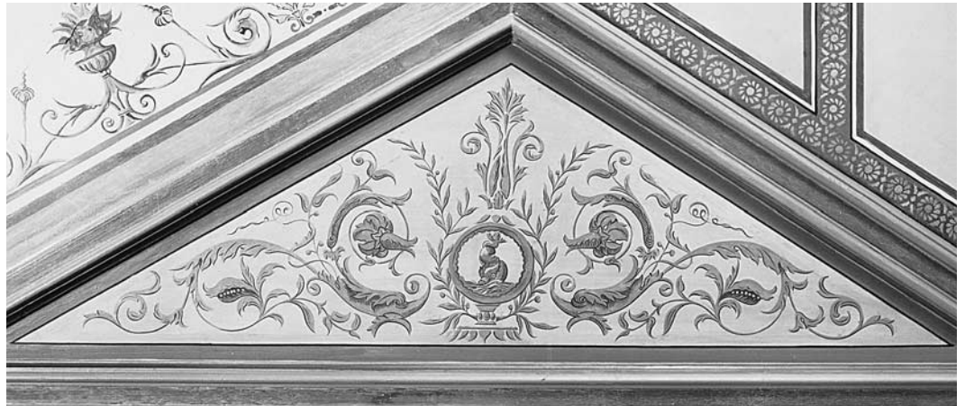
Detail der Deckenmalerei in der Halle (Raum 0.2) im Erdgeschoss, vor der Restaurierung. Zustand 1984.
