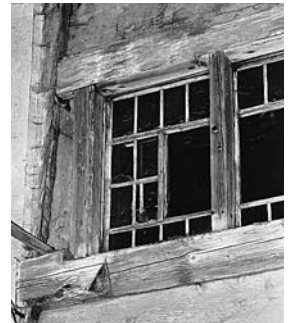
Originales Doppelfenster an der rückseitigen Bohlenständerfassade, vor der Renovation. Zustand 1987. (Vgl. Bild unten).
