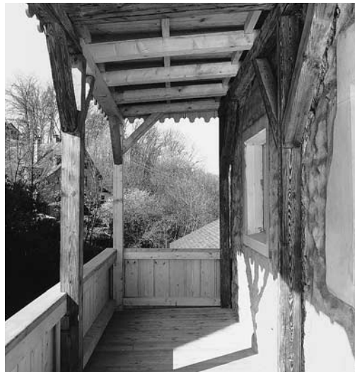
Untere Rheingasse 5, Haus «Zum Bären» oder «Vordere Farb» Vers. Nr. 294. Ansichten nach Umbau und Renovation 1992–1993. Keller (links) und Laube an der rückseitigen Fassade (rechts). Zustand 1993.
