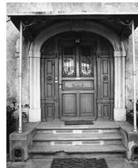
Hauptportal am Haus Seestrasse 119, abgebrochen 1988: Türgewände von 1826, Türblatt von 1878. Zustand 1977.
