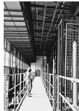
Galerie im 50 kV-Schaltheis. Zustand 1986.
