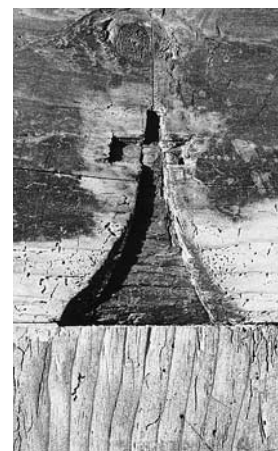
Fragment einer Kielbogenbekrönung in Kreuzform an der Nordwestfassade des Hauses. Zustand 1985.
