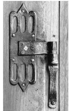
Eisenbeschlag an einer Zimmertüre im 1. Obergeschoss. Zustand 1988.
