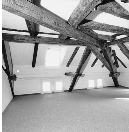
Links: Untere Rheingasse 3, Haus «Zur Hoffnung» Vers. Nr. 295. Dachstock wohl aus dem 15. Jahrhundert, vor dem Ausbau. Zustand 1985.
