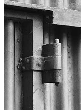
Band der Eingangstüre an der Südfassade des 135/150 kV-Schalthauses. Zustand 1989.
