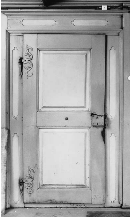
Zwei Stubentüren vor der Renovation. Zustand 1987.
