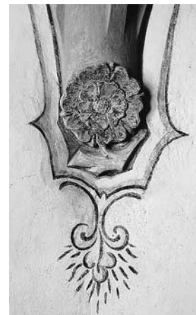
Spätgotische Gewölbekonsolle im Chor mit farbig gefasster Steinrose, umgeben von Begleitlinien. Nach der Restaurierung. Zustand 1991.
