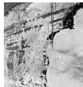
Freigelegtes Fragment ei- nes Kapitells von der ge- malten Fassadendekoration an der Südwestseite. Zu- stand 1992. Heute wieder zugedeckt.
