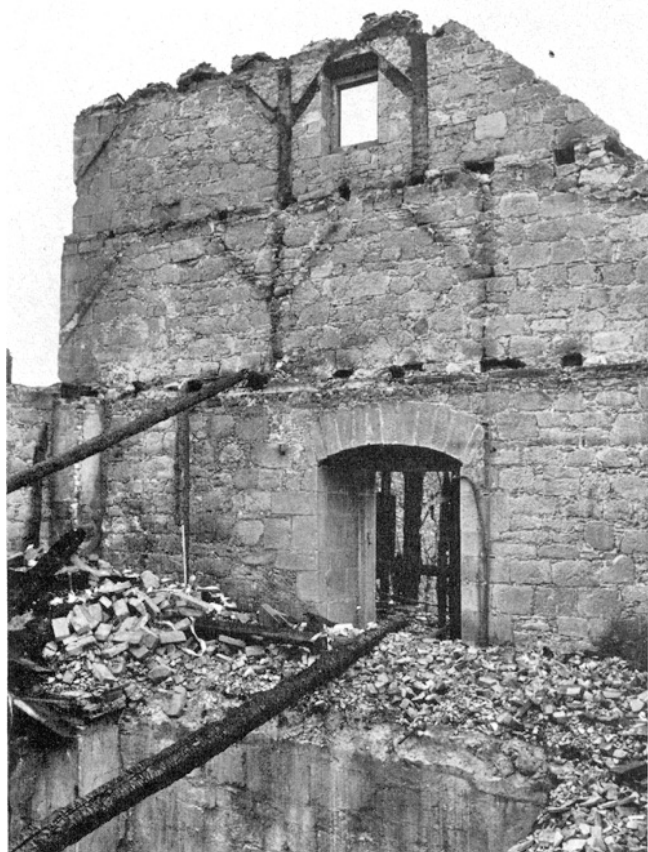
Grüningen. Schloss. Turm. Oberstes Geschoss. Westmauer. Nach dem Brand vom 20. Oktober 1970.
