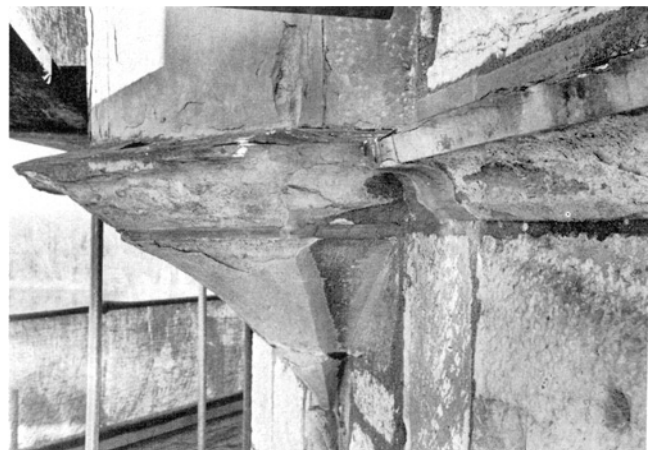
Rheinau. Ehem. Klosterkirche, Nordturm. Erkerkonsolen vor der Restaurierung. Oben: auf der Ostseite; unten: auf der Nordseite.
