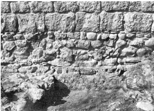
Freienstein-Teufen. Burgruine Freienstein. Südmauer. Nach der Konservierung 1975–1977. Von unten nach oben: Fundamentzone, feine Rollkieselschicht, ergänzte Tuffsteinpartie.
