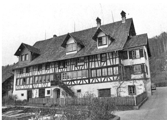
Hausen a. A. Husertal. Reihenhaus Vers. Nr. 403/405. Nach der Teil-Aussenrestaurierung 1975 des Hausteils Vers. Nr. 403 (links).
