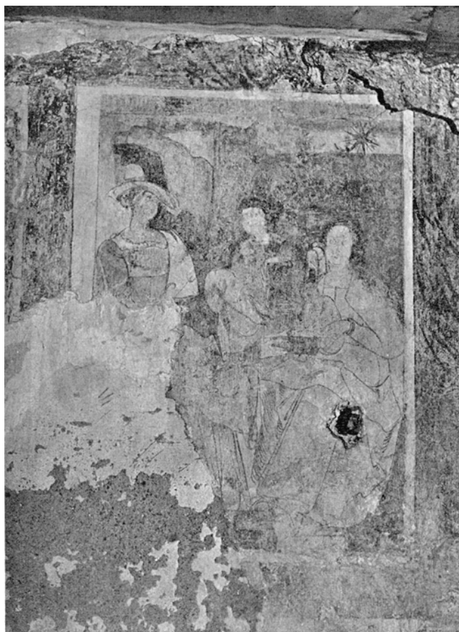
Laufen-Uhwiesen. Uhwiesen. Kapelle. Nordostwand. Das Bild «Heilige Drei Könige» (Feld 2) vor der Restaurierung 1972/74.
