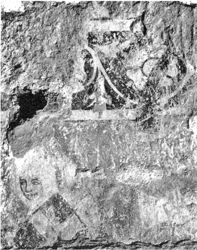
Dinhard. Reformierte Kirche. Schiff. Südwand bei Südwestecke. Wandmalereireste des 14. Jahrhunderts. Nach der Freilegung im Dezember 1971.
