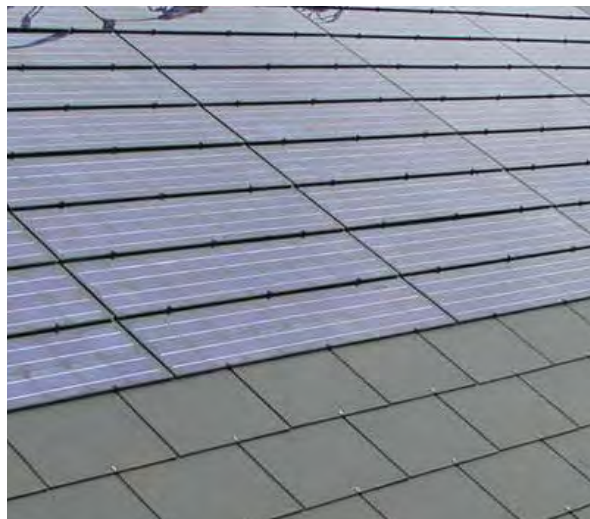
Dachintegriertes Voltaiksystem in Kombination mit Faserzementschiefern (Abb. 23)
