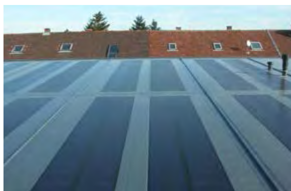
Dünnschichtlaminat als Voltaikolektoren und Dachhaut zugleich (Abb. 40)
