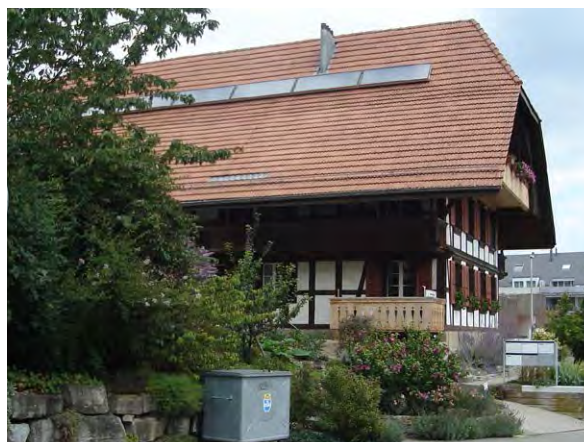
Thermische Kollektoren, Aufdachmontage, Gebäude an der Wangentalstrasse in Niederwangen (Abb. 30)
