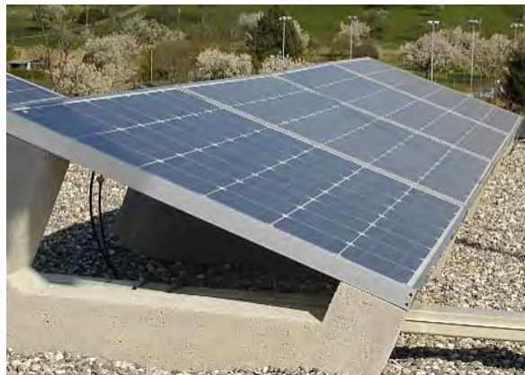
Voltaikolektoren auf Wohnhaus in Reihen (Abb. 39)
