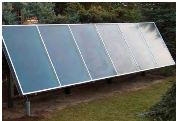
Geständerte Kollektoren (Abb. 27)
