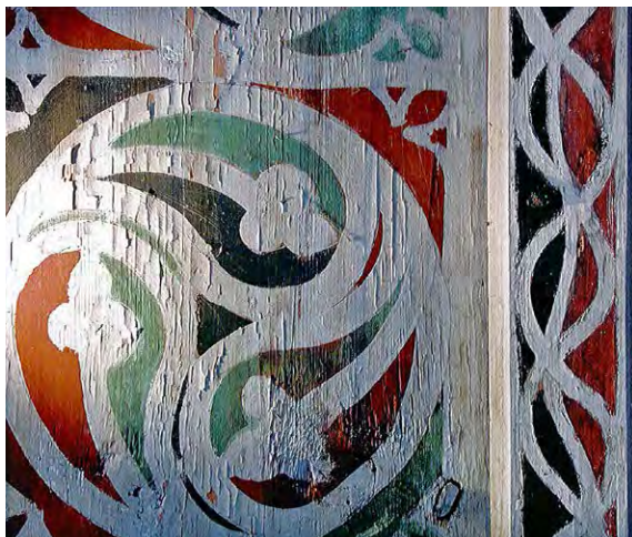
Evangelische Kirche Bergün, schadhafte Partie der gotischen Decke. Der Bereich befindet sich direkt oberhalb der Fensterbankheizung (Abb. 20)
