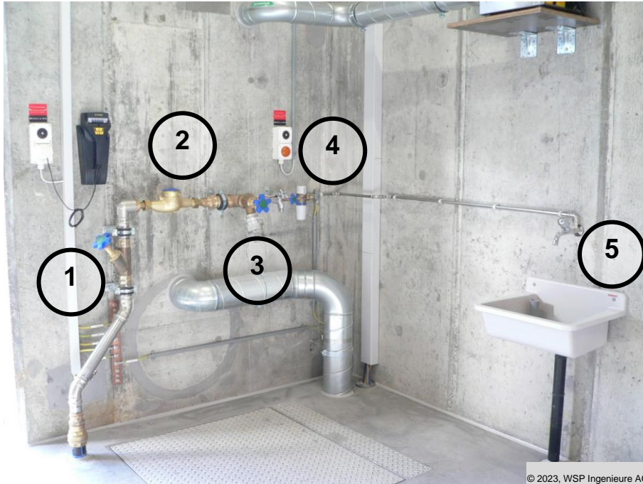
Abbildung 15: Beispiel Sanitärinstallation im Betriebsraum über Pumpenschacht, Pumpwerk Wanne, Hinwil
