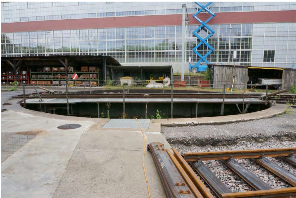
Bahninfrastrukturbauten zwischen Wylandbrücke und Lindspitz, Drehscheibe (237DREH01043), Ansicht von O, 20.07.2017 (Bild Nr. D101146_89).
