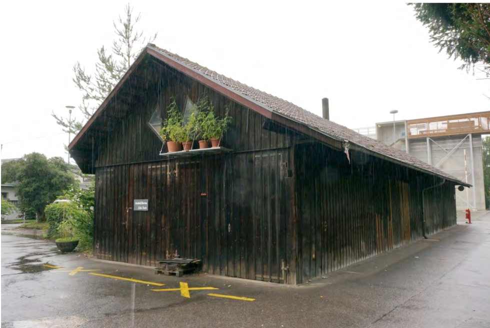
Bahninfrastrukturbauten zwischen Wylandbrücke und Lindspitz, Magazingebäude (Vers. Nr. 02558), Ansicht von O, 20.07.2017 (Bild Nr. D101146_27).
