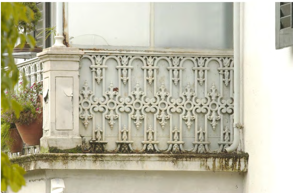
Landsitz Rosenberg, ehem. Villa Bidermann (Vers. Nr. 00551), Veranda auf der Südwestseite, Geländer (Detail), 04.09.2001 (Bild Nr. D100212_10).
