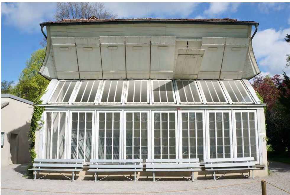
Ensemble Museum Lindengut, ehem. Gärtnerhaus (Vers. Nr. 00040), Ansicht von S, 15.04.2014 (Bild Nr. D100639_12).
